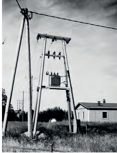
Turvallisemmat pylväsmuuntamot korvasivat koppimuuntamot 1950- ja 60-luvuilla.
