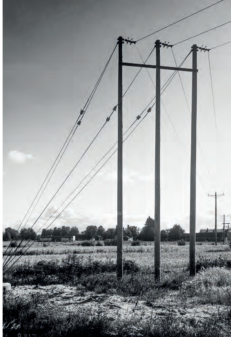
Kahdenkymmenen kilovoltin johdon 3-pylväskulma.
